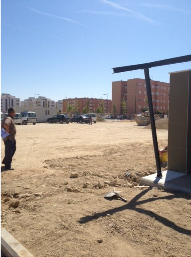
VALLADO DE PARCELA EN LINDE ESTE NO EJECUTADO
