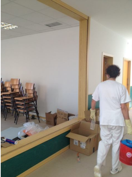
FALTAN ACABADOS DE CARPINTERIA Y VIDRERIA
