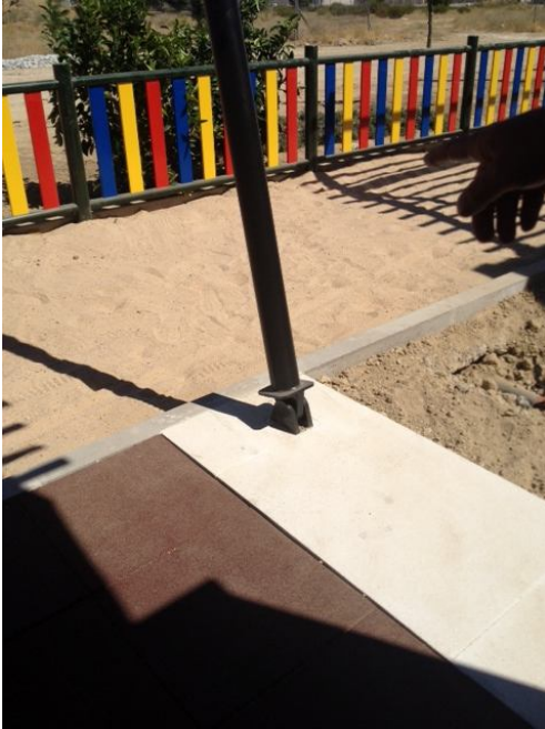
ARTICULACION DE PERGOLA JUNTO A ARENERO DE JUEGOS. ELEMENTO PELIGROSO. CTE DBSUA.
