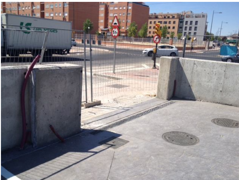
NO SE HA COLOCADO PUERTA DE ACCESO
