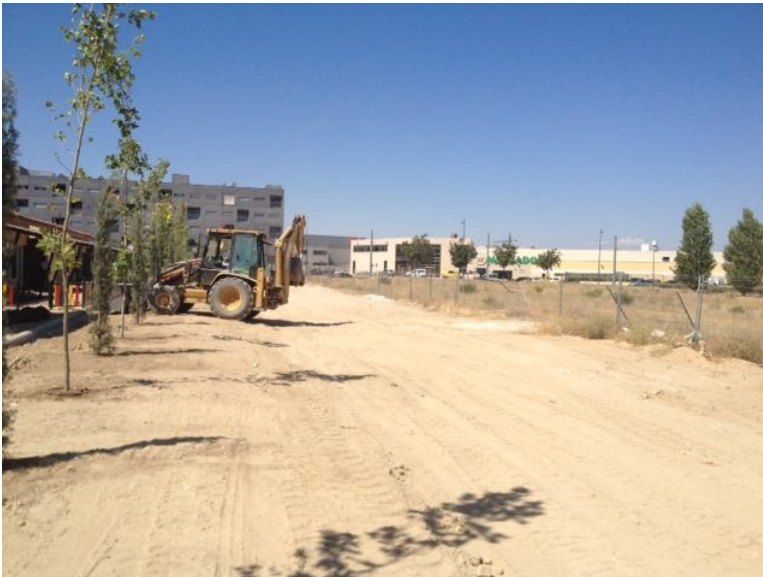
VALLADO DE PARCELA EN LINDE NORTE NO EJECUTADO
